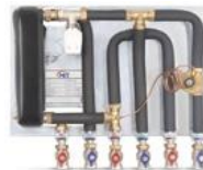
DAİRE GİRİŞ İSTASYONU
